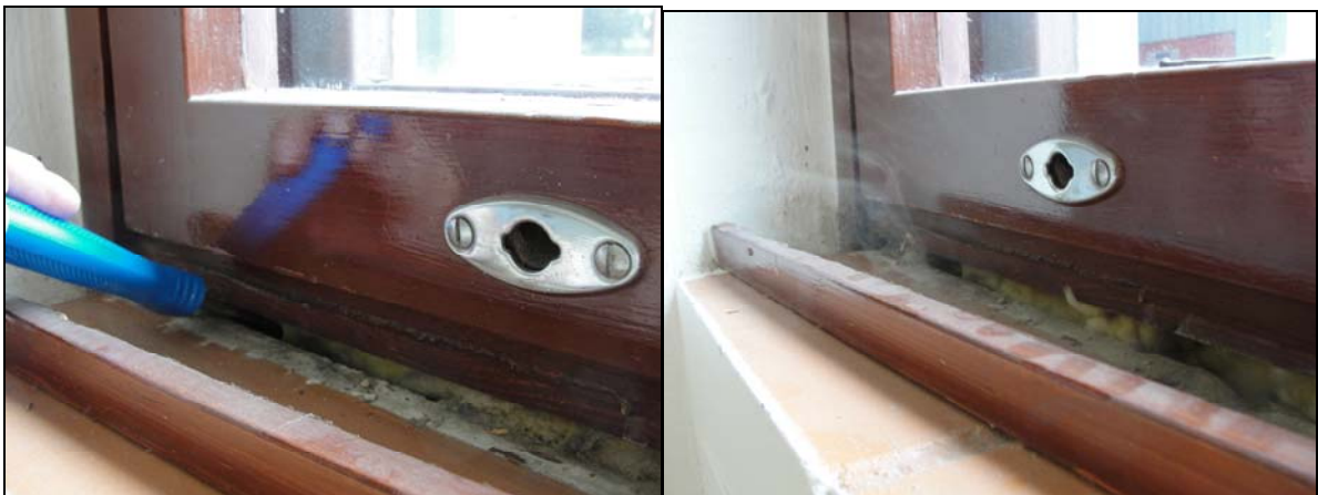
Kuva 3. Alakäytävän ikkunoiden tilkevälistä on suora ilmayhteys seinän eristetilaan ja eristeet pölyävät voimakkaasti.
