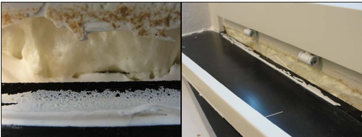
Kuva 2. Ikkunoiden uretaanieristys on avoin seinän eristetilaan.
