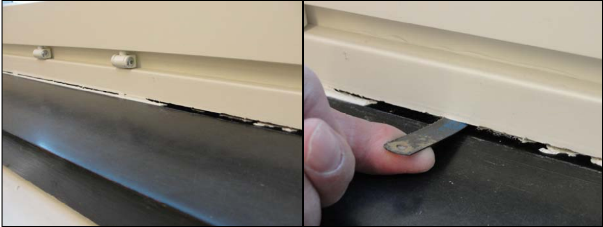
Kuva 1. Ikkunoiden liittymät seinärakenteeseen ovat avonaisia.
