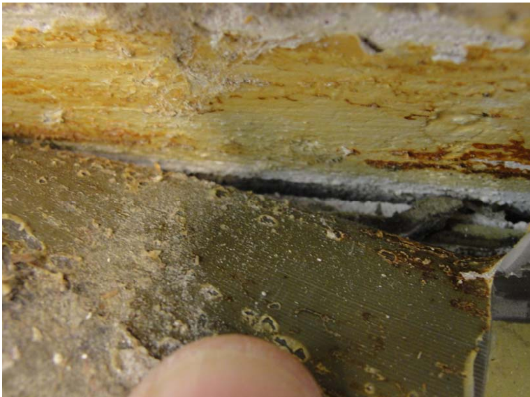
Kuva 5. Lattioiden ja seinien liittymät ovat avoimia.
