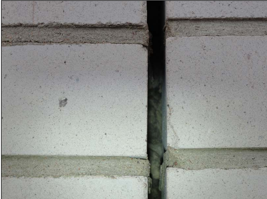
Kuva 6. Ulkoseinän liikuntasauma on avoin lämmöneristeisiin.
