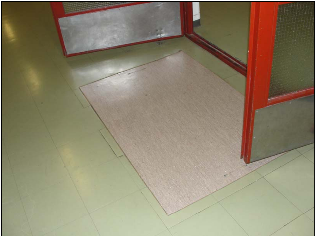
Kuva 7. Alakäytävällä epätiivis kanaalin huoltoluukku.
